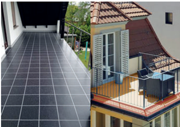
Grundsätzlich ist ein nicht überdachter Balkon anfälliger für Schäden, da er stärker der Witterung (Schnee, Frost, Regen etc.) ausgesetzt ist.
