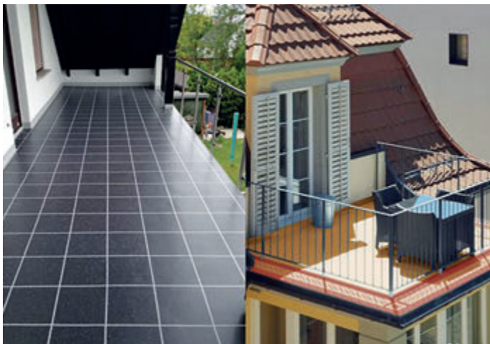
Grundsätzlich ist ein nicht überdachter Balkon anfälliger für Schäden, da er stärker der Witterung (Schnee, Frost, Regen etc.) ausgesetzt ist.
