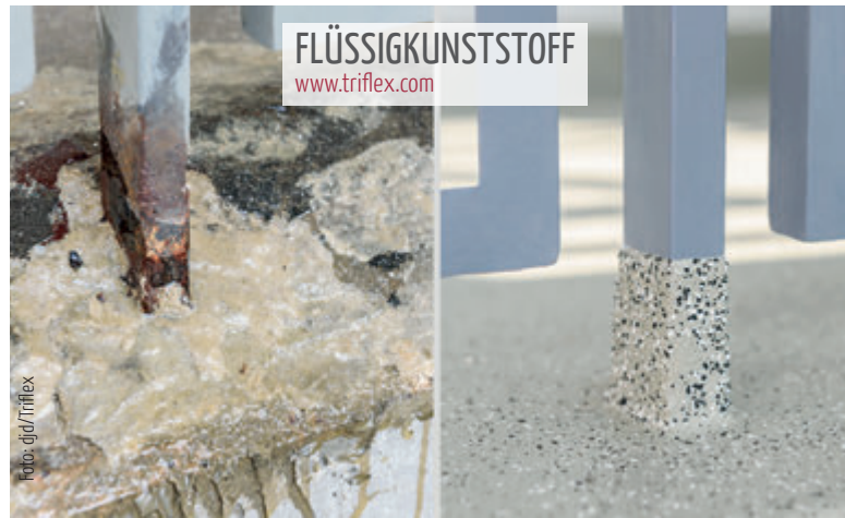
Bei einem nicht akkurat abgedichteten Balkongeländer droht das Eindringen von Feuchtigkeit (links). Mit Flüssigkunststoff lassen sich Details und Übergänge unterschiedlicher Materialien langzeitsicher abdichten (rechts).
